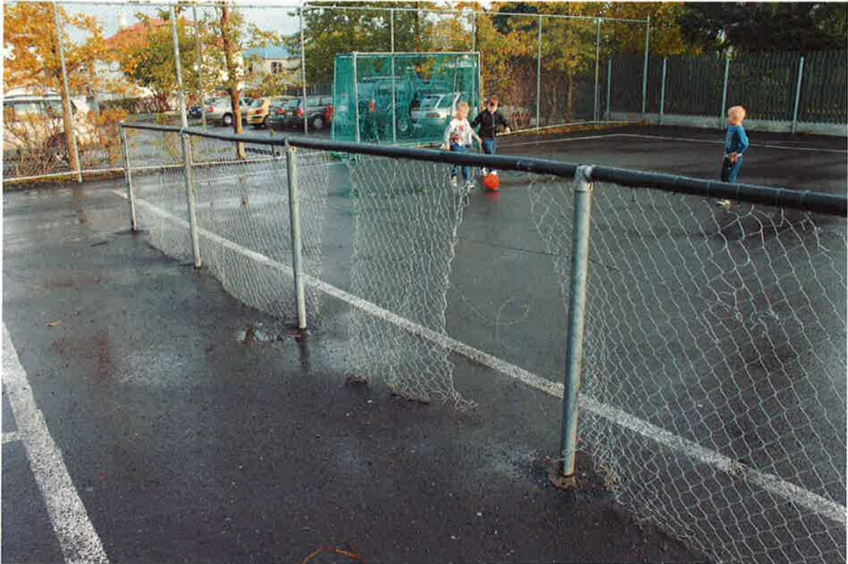
Mynd 3. Ónýt grindverk.
